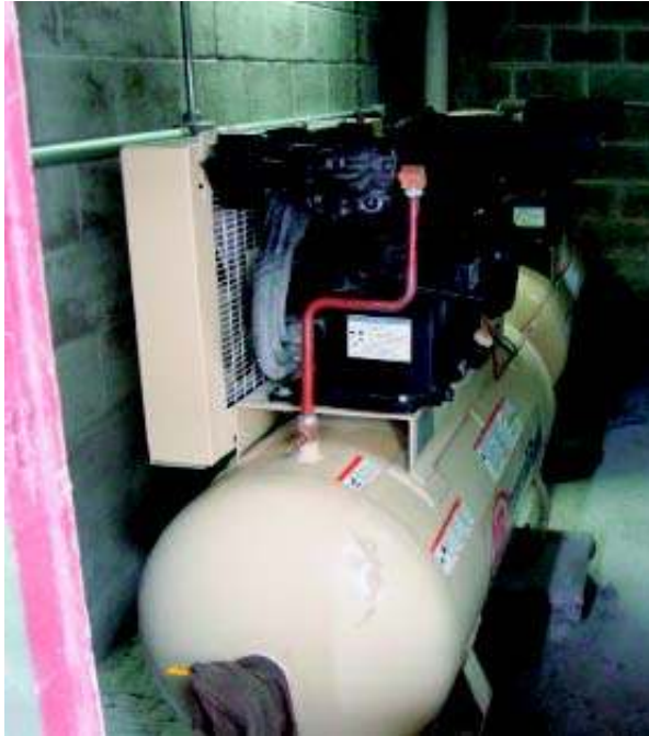
▲ Fig. 5: Compressor isolado e enclausurado
