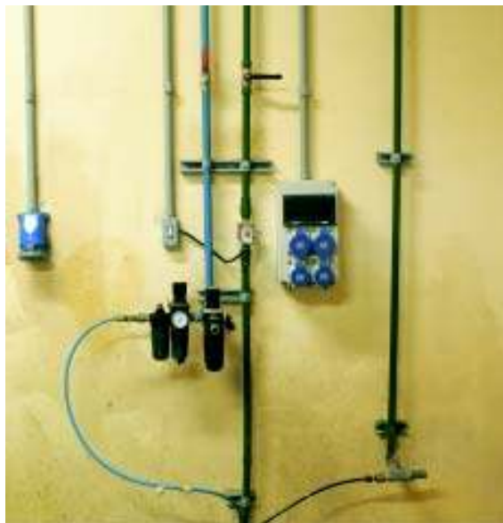
▲ Fig. 8: Instalações elétricas, de linhas de ar pressurizadas e de água
